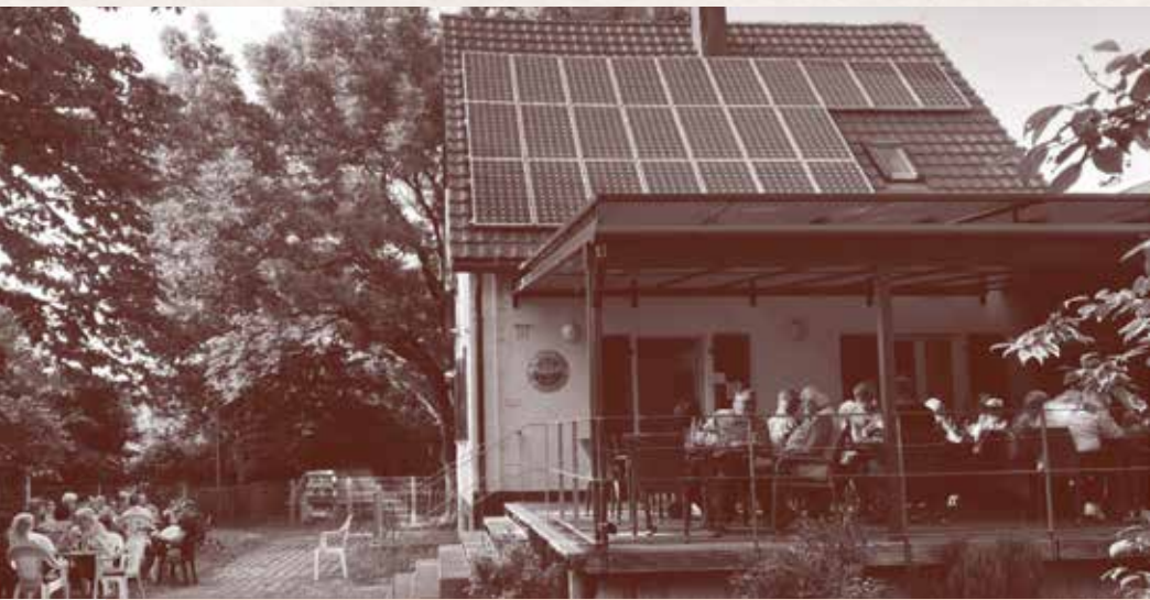
Photovoltaik am Naturfreundehaus Schwaikheim
